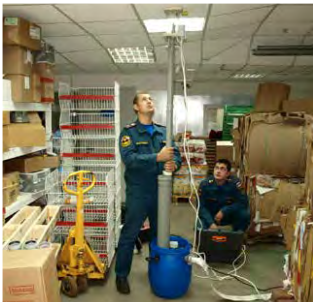
Проверка работоспособности спринклерных систем пожаротушения с применением гидротестера
