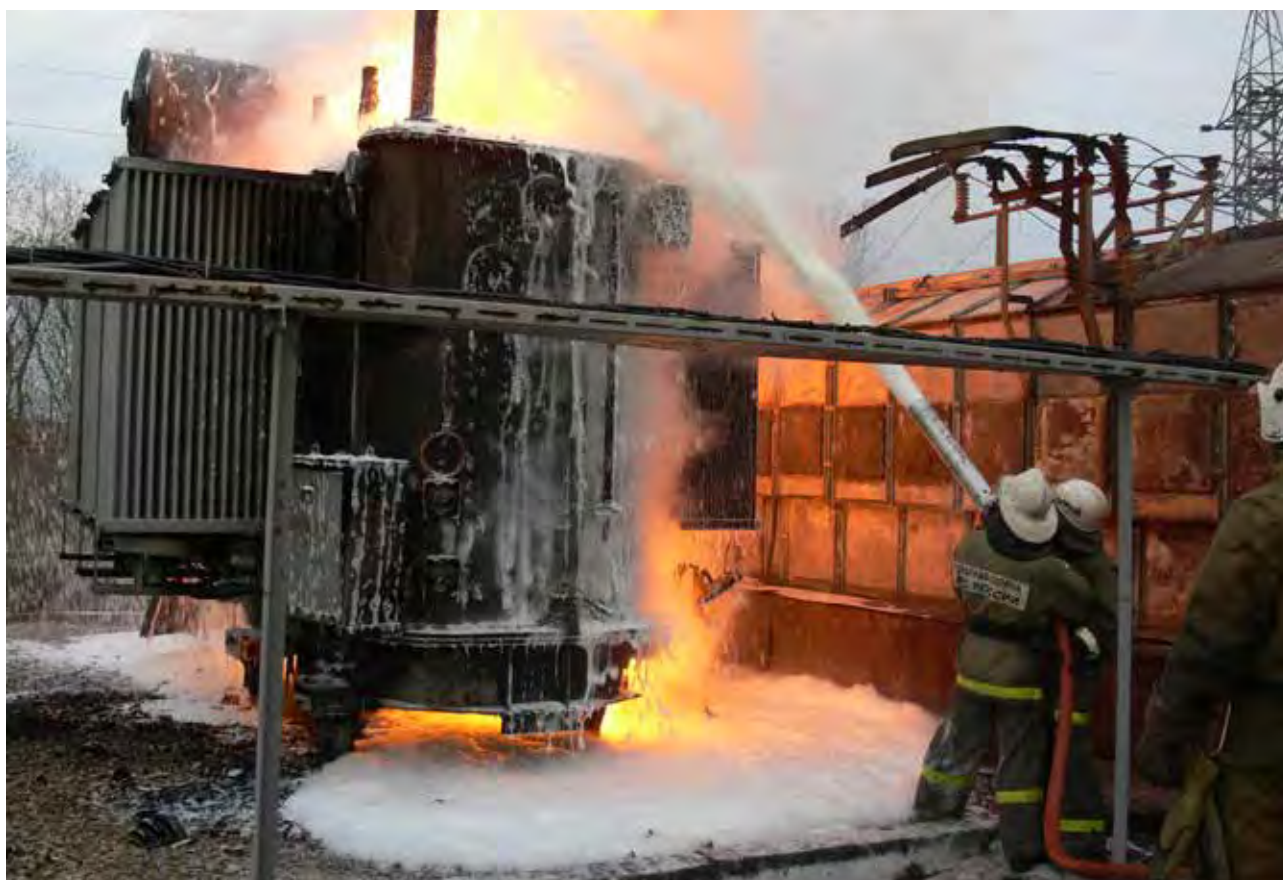
на электроподстанции. Плавск. 03.05.2011 г.
